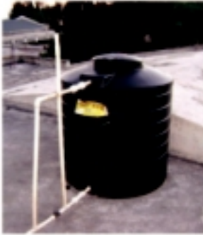
خزان مياه شكل (١٦)
